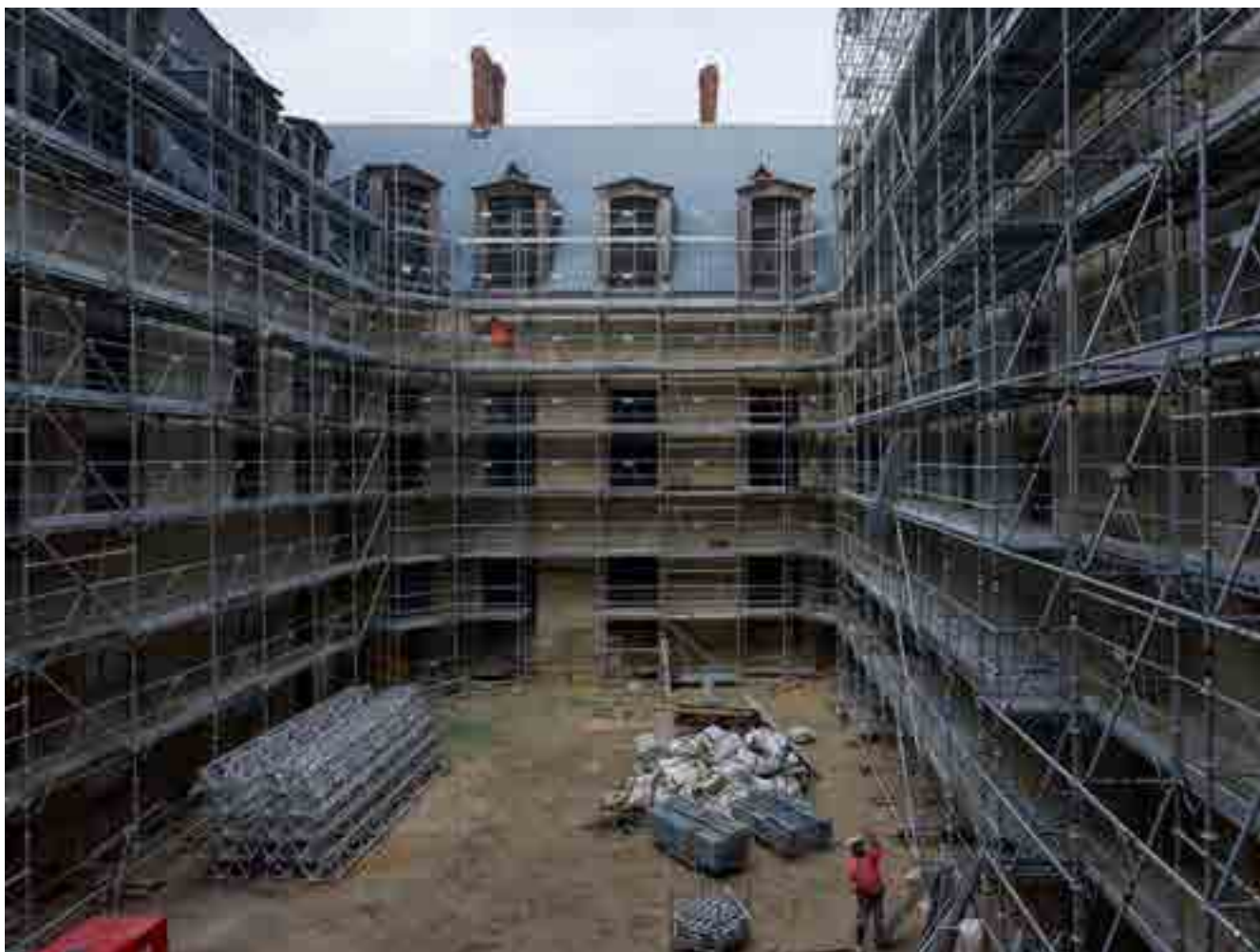
Chantier et montage des échafaudages du Logis royal © Pierre-Olivier Deschamps / Agence Vu' - CMN
